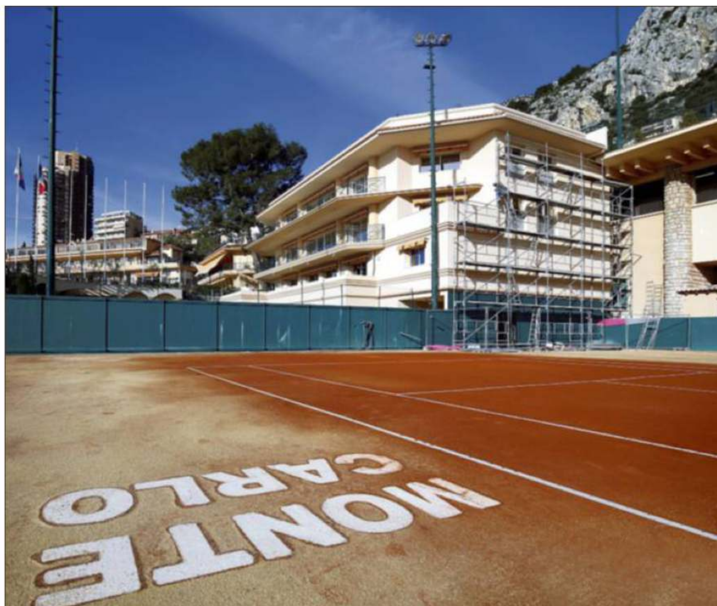
Depuis 2016, des travaux étaient engagés pour ériger ce bâtiment. Lequel accueillera la production de télévision, le restaurant des joueurs ou encore la salle d'interviews.
