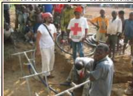
Installation des canalisations par Sylvain RICCIO et les équipiers de la Croix-Rouge française.
